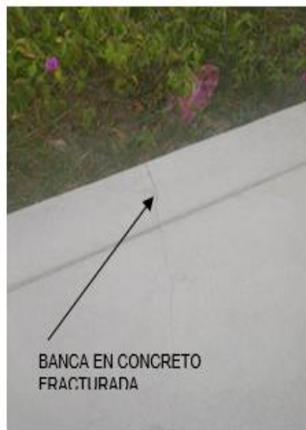
Fuente: Visita de obra CGR del 6 al 8 abril de 2021
