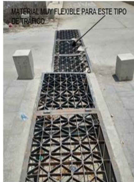
Fuente: Visita de obra CGR del 6 al 8 abril de 2021
